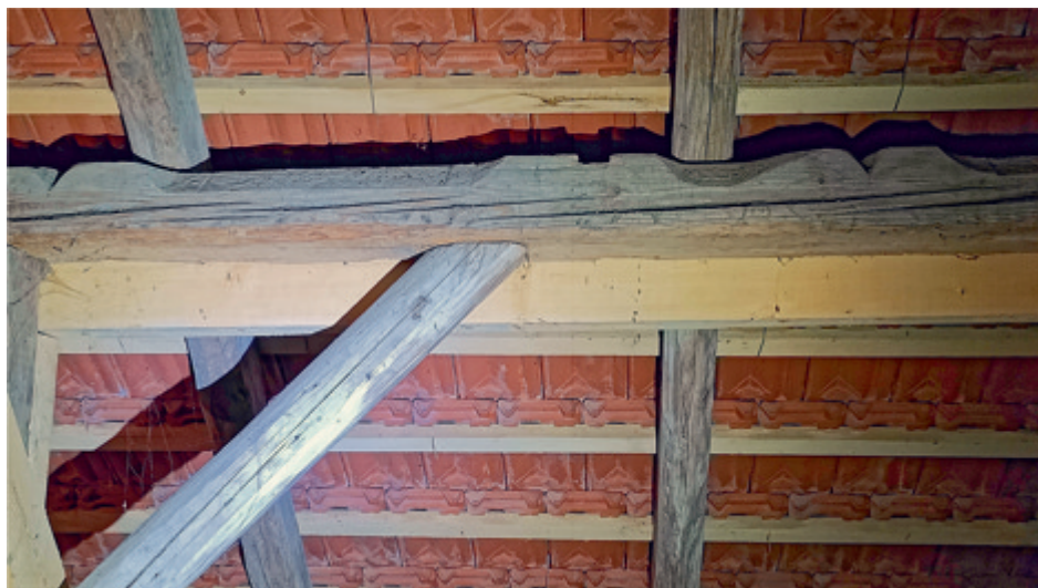
Abb. 11: Zweitverwendung der historischen Fußpfette, Zustand 2013.
