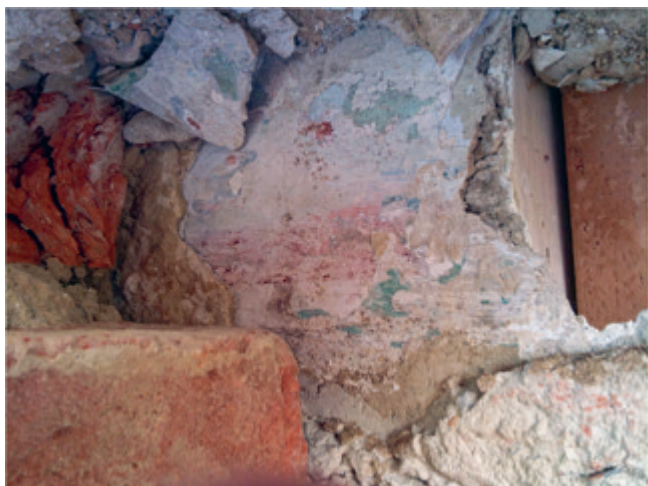
Abb. 25: Reste der Farbfassung rund um die Fenster auf der Westseite, 2013.
