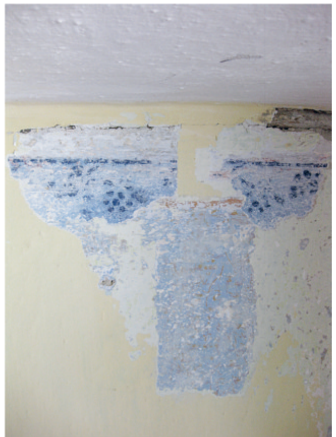
Abb. 22: Partiell freigelegte Schablonenmalerei, Zustand 2011.
